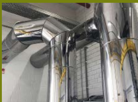
Дымовые трубы котлов выполнены из нержавеющей стали (такие спокойно перенесут воздействие как влаги, так и кислот)
