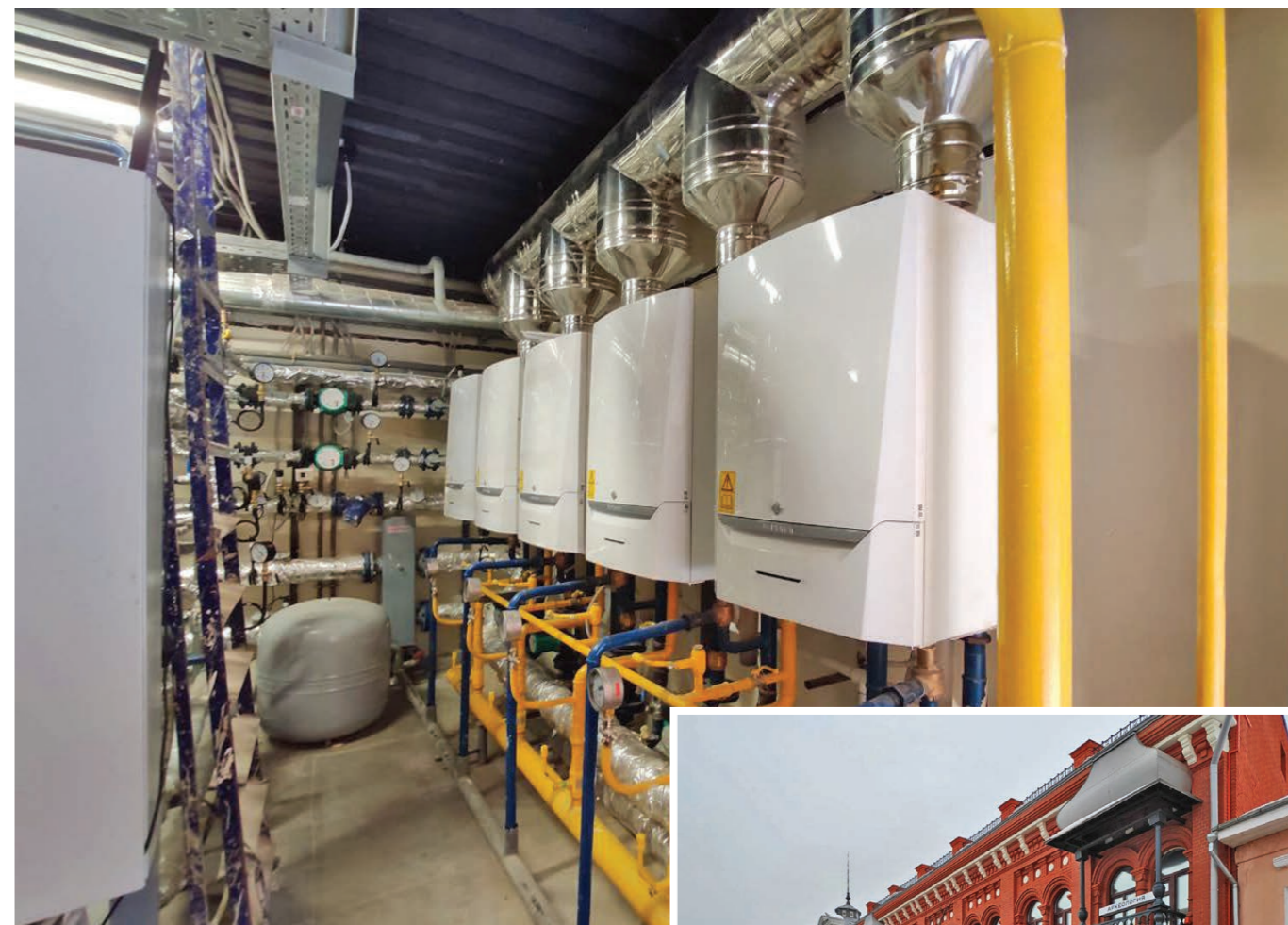
Котельная в историческом центре г. Тулы
